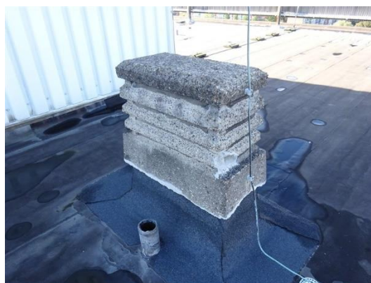
Ventilatie afvoer bovendaks
