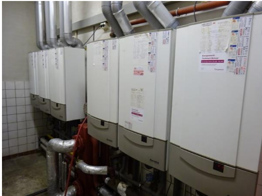
Cascade opstelling Cv-ketels - verwarmen
