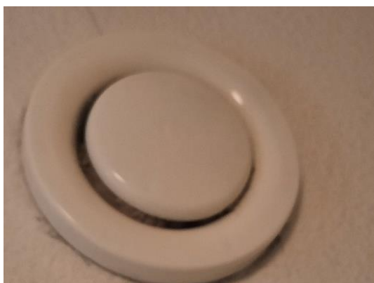
Ventilatie afvoer roosters woning
