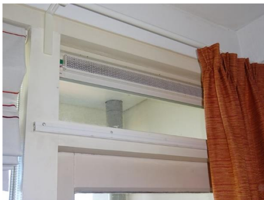
Ventilatie toevoer via roosters
